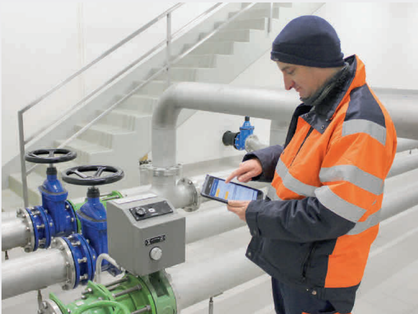
Fig. 5 Florian Bissig erledigt die Kontrollen im Reservoir.
