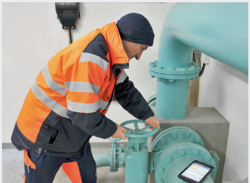
Fig. 3 Florian Bissig prüft die Armaturen im Übergabeschacht und dokumentiert diese digital.
