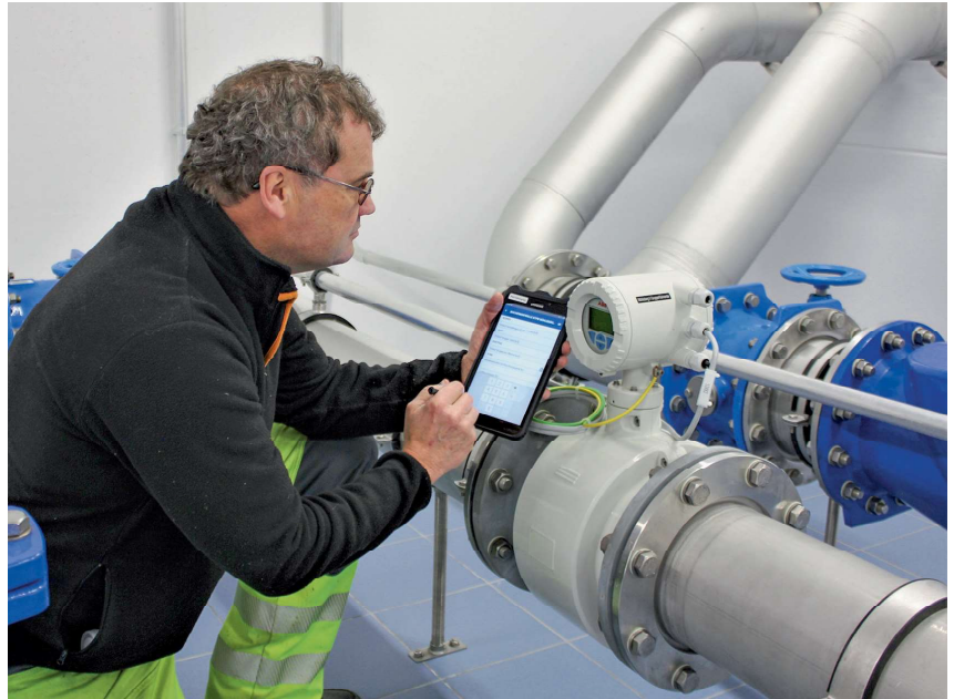
Gerhard Bichsel von der Gruppenwasserversorgung Thurtal-Andelfingen erfasst Messwerte und Checkpunkte digital.
